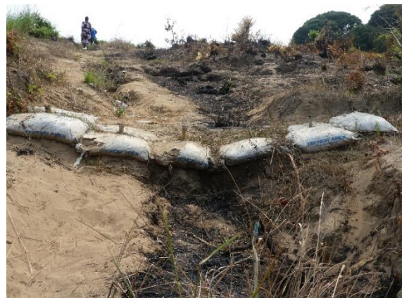
FIGURE 10 : Mur de sac de sable situé dans un canal d'écoulement de l'eau de ruissellement (photographie prise à Kinshasa dans le quartier de Kimuenza)
