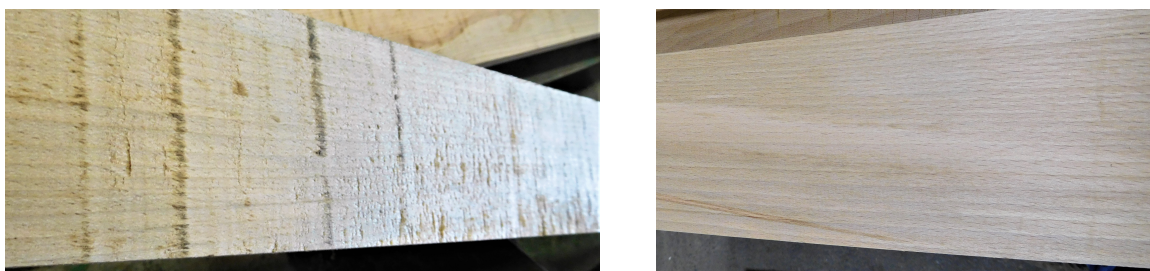
FIGURE 18 – Exemple de rabotage non conforme (gauche) et rabotage conforme (droite) (Photographies personnelles).
