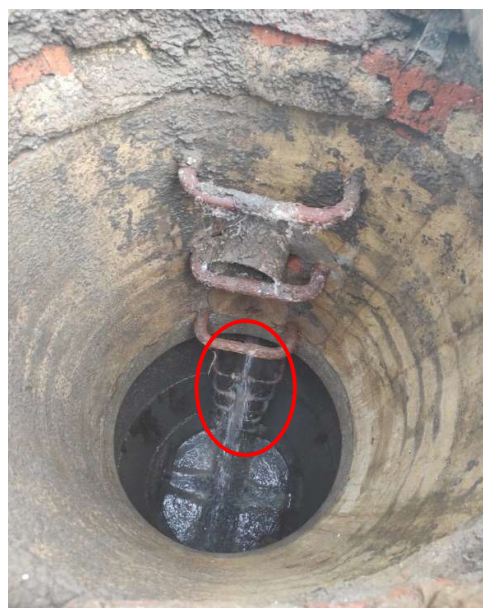
Figure 10-5: Afflux d'eau direct venant de la chambre de raccordement d'eaux de pluie.
