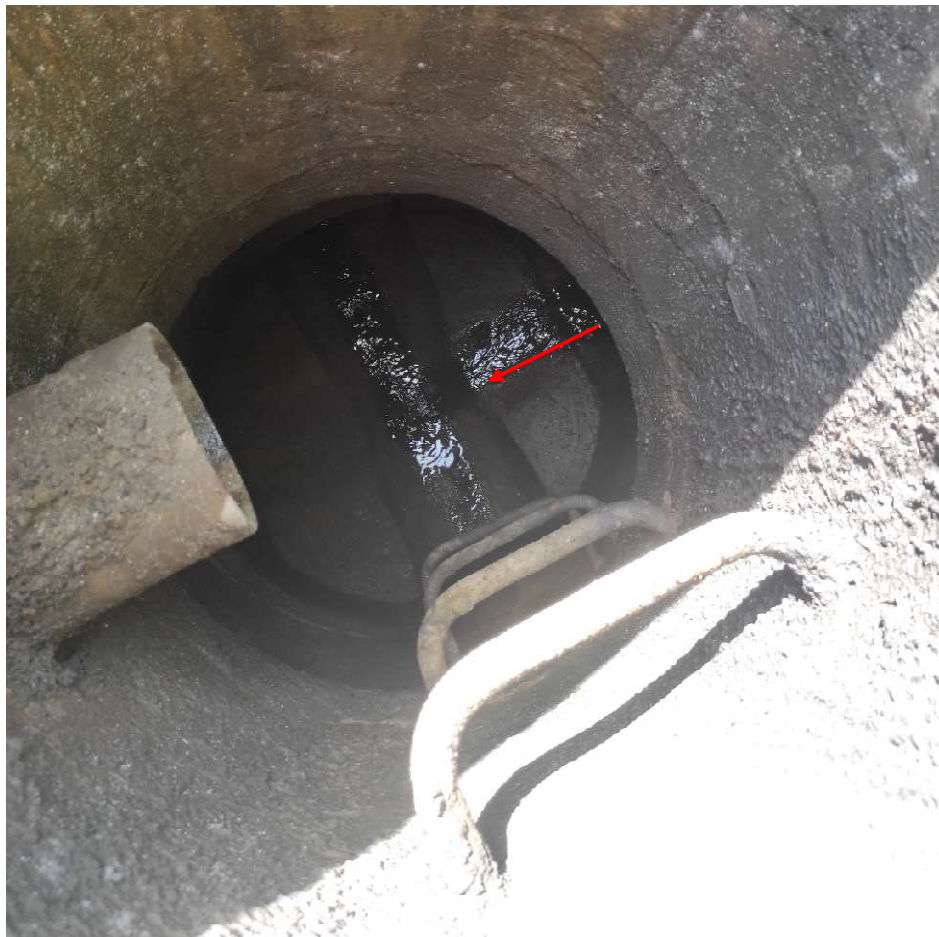
Figure 10-1: Afflux d'eau venant de l'avaloir dans la chambre de visite d'eau de pluie.
