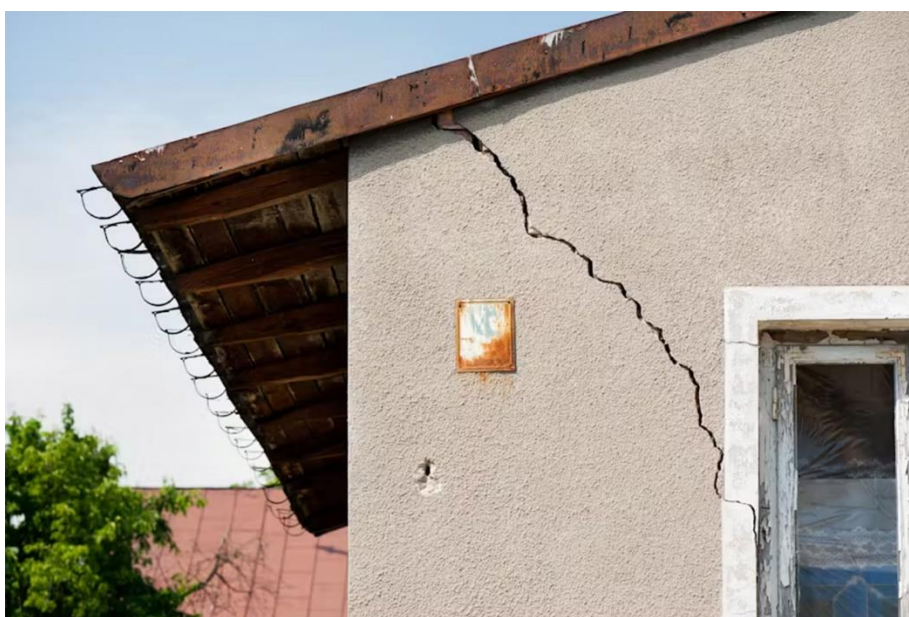
Photo 2. : Un mur fissuré sous l'effet de RGA [41].
