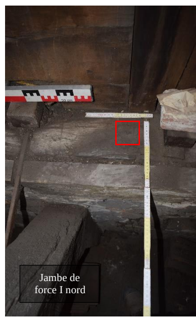
Fig. 36. Traces de clou arraché dans la sablière (US 3065), EA S3.1 MN, cliché de F. Van Boxem
