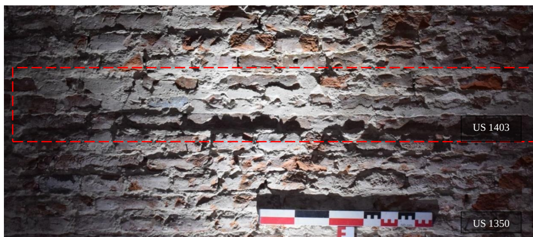
Fig. 109. Retrait de la maçonnerie et écrasement du mortier (US 1403), EA S1.3 MN, cliché de F. Van Boxem
