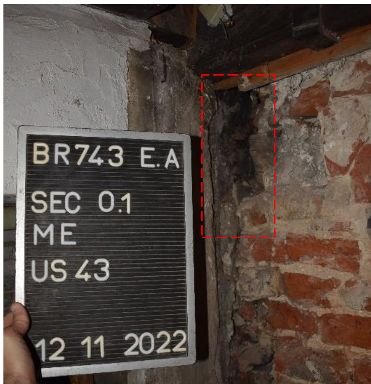
Fig. 47. Détail de l'US 43 (encadrée en rouge) à l'arrière du coffrage de ciment (US 44), EA S0.1 ME, cliché de F. Van Boxem
