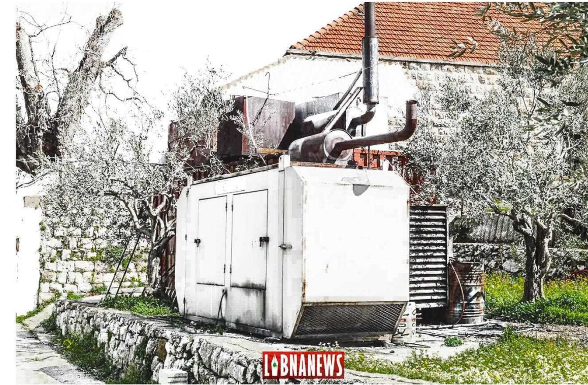
Générateur électrique à Mazout de 200 KVA ou environ 100 Abonnés.
