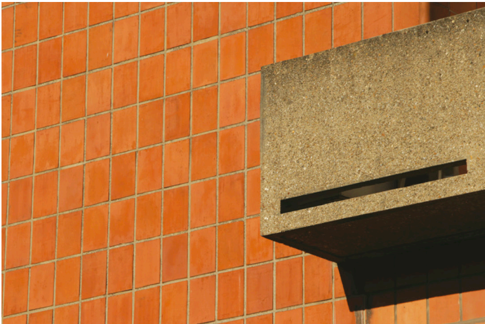
Figure: Crédit photo Steve Abraham et Myriam Morlion, «Ilots rouges, détail d'échappée d'eau d'un balcon en béton sur fond de carreau de terre-cuite»
