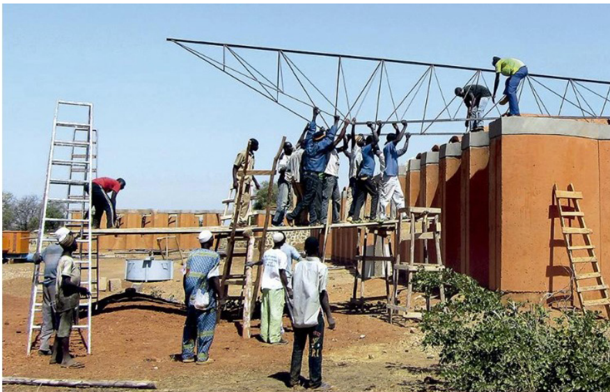
Les artisans au travail sur le chantier du collège de Gando ©ArquitecturaViva
