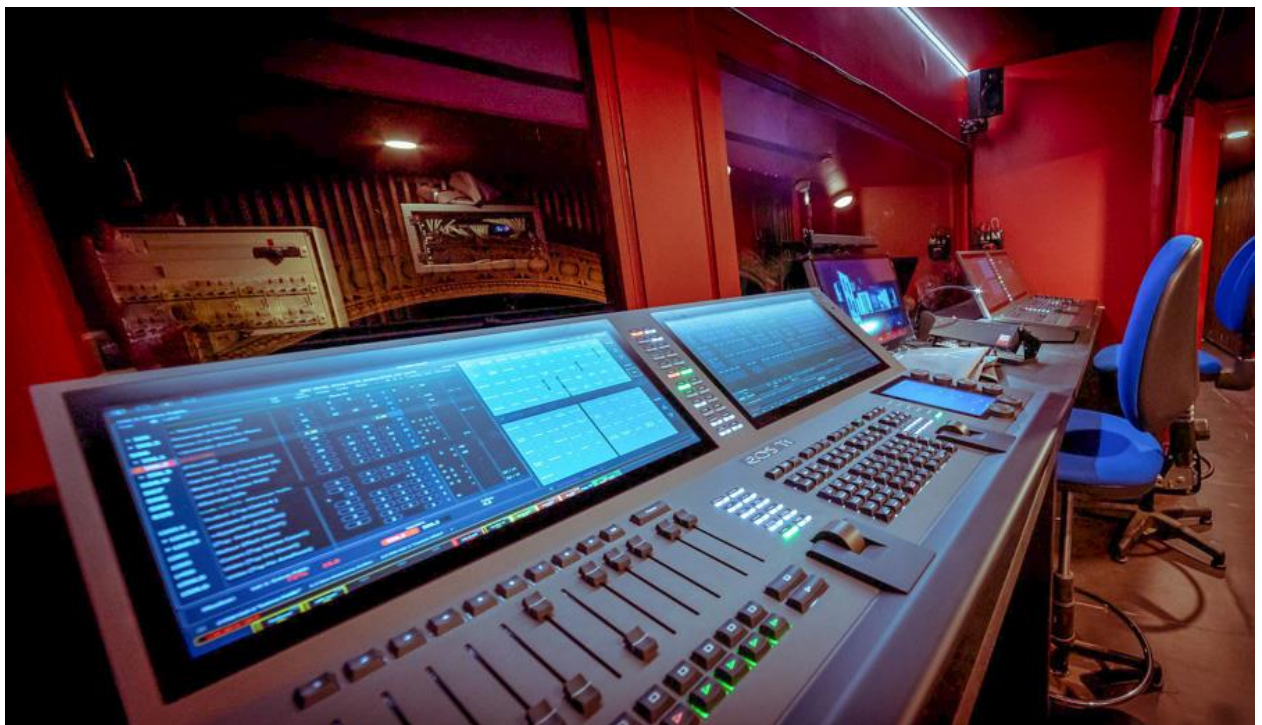
Annexe 28 - pupitres de contrôle à distance numériques – Theatre Chatelet 150 .
