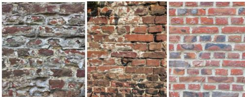
Figure 70 : Différentes pathologies touchant les briques et mortiers : (Desquamation, Farinage du mortier, Réparations au mortier de ciment) – Photos Personnelles -
