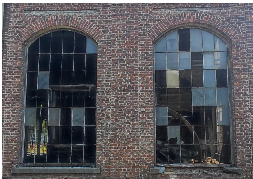
Figure 73 : Etat actuel des châssis - Photo personnelle -
