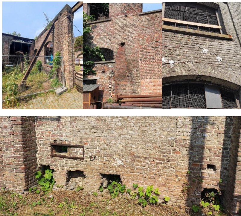
Figure 71 : Pathologies et désordres structurels (Fissures, tassements ...) - Photos Personnelles -
