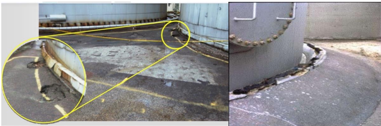
Figure 21 : Illustrations d'un tassement sous réservoir avec fissuration de la fondation
