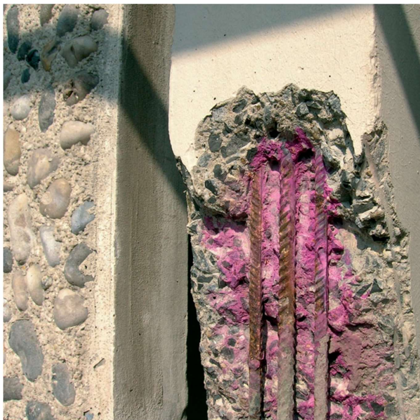
Figure 13 : béton armé qui présente des dégradations
