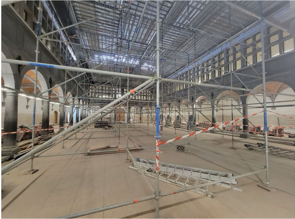
Fig. 25 La Halle aux draps de Tournai en rénovation Source : EdA, sans titre , date inconnue.
