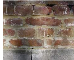
Fig. 49 – Joint mortier de ciment
