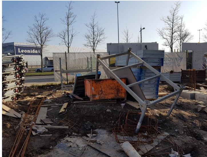
FIGURE 5 – Exemple de mauvais stockage sur le projet City Dox (Besix)
