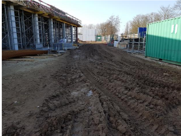
FIGURE 15 – Exemple de l'état des pistes sur chantier
