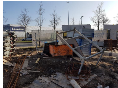
FIGURE 12 – Exemple de désordre dans une zone de stockage
