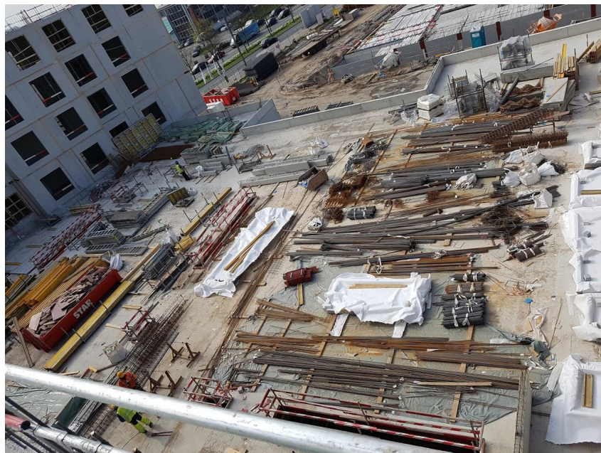
FIGURE 54 – Une zone de stockage plane non répertoriée sur les plans sur le chantier de City Dox (Bruxelles)
