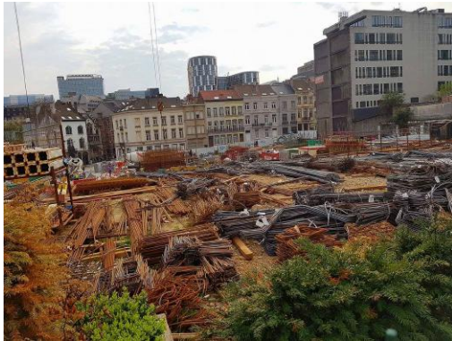
FIGURE 23 – Exemple de sur-stock d'acier sur chantier
