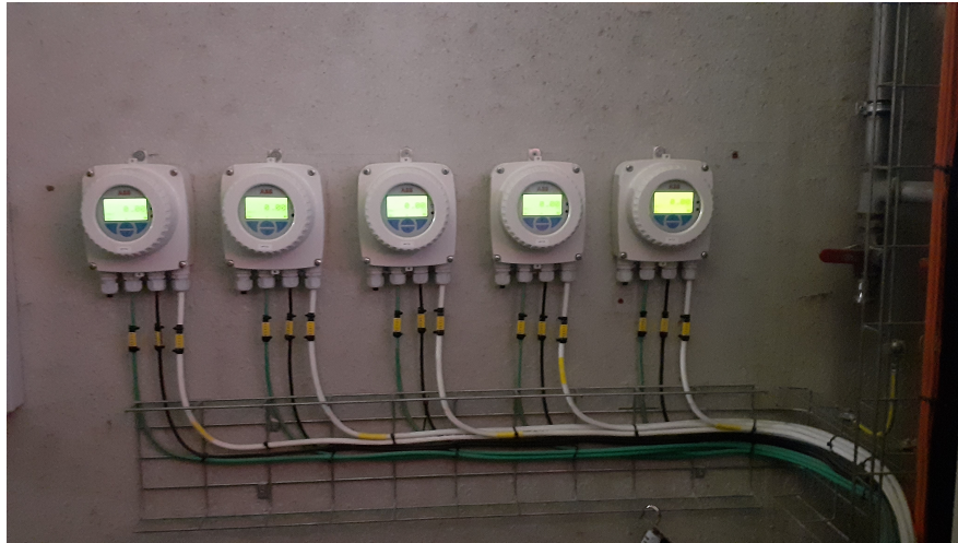
FIGURE 4.1 – Débitmètres pour les différentes pompes.
