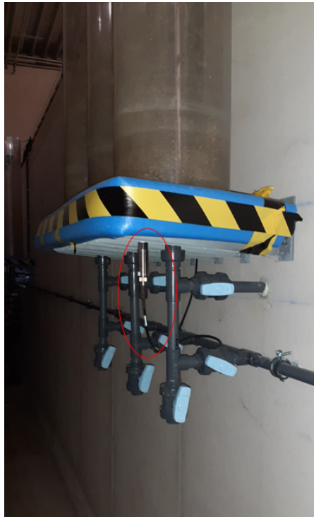
FIGURE 4.4 – Capteur hydrostatique présent sur site.
