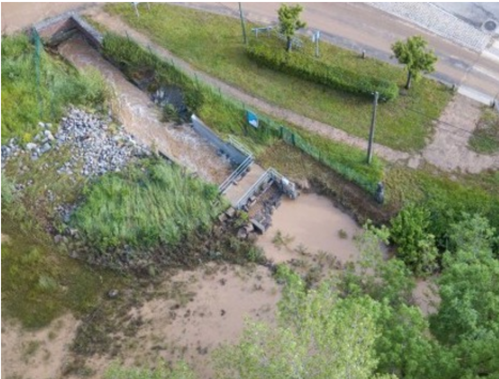
FIGURE 3.14 : Etat de la surverse et de la berge en face au lendemain d'une inondation[24].
