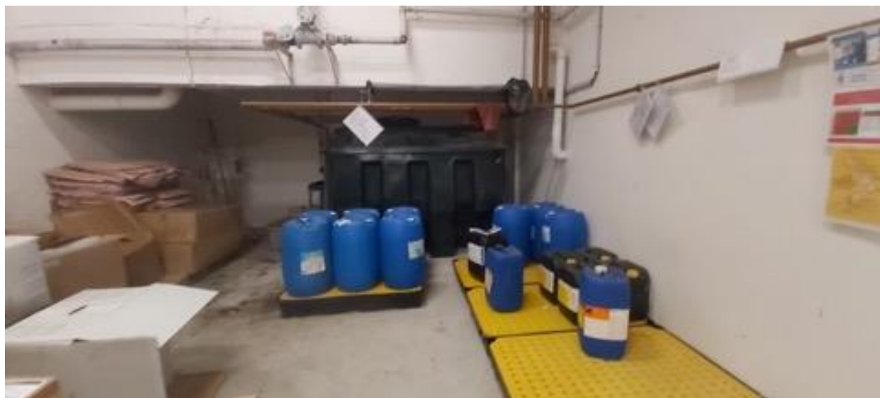
Figure 12: Bacs de rétention des produits dangereux.
