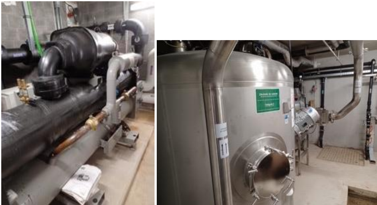
Figure 18 : Pompe à chaleur à gauche et séparateur de graisse à droite.
