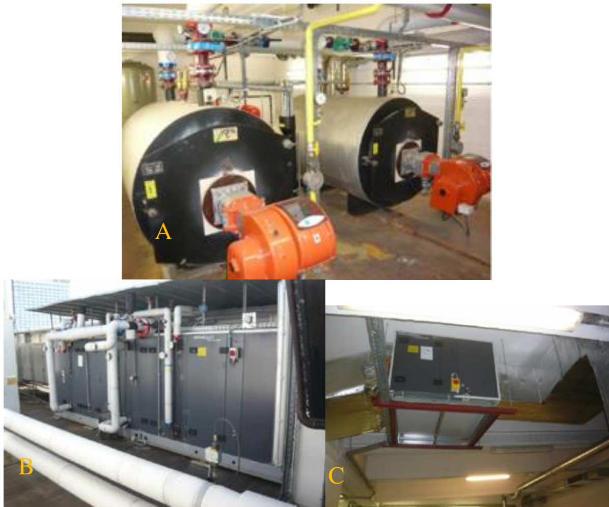
Figure 6: chaufferie et groupe de ventilation avec contrôle horaire. A : chaudières Ygnis, B : Groupe de pulsion, C : groupe d'extraction.
