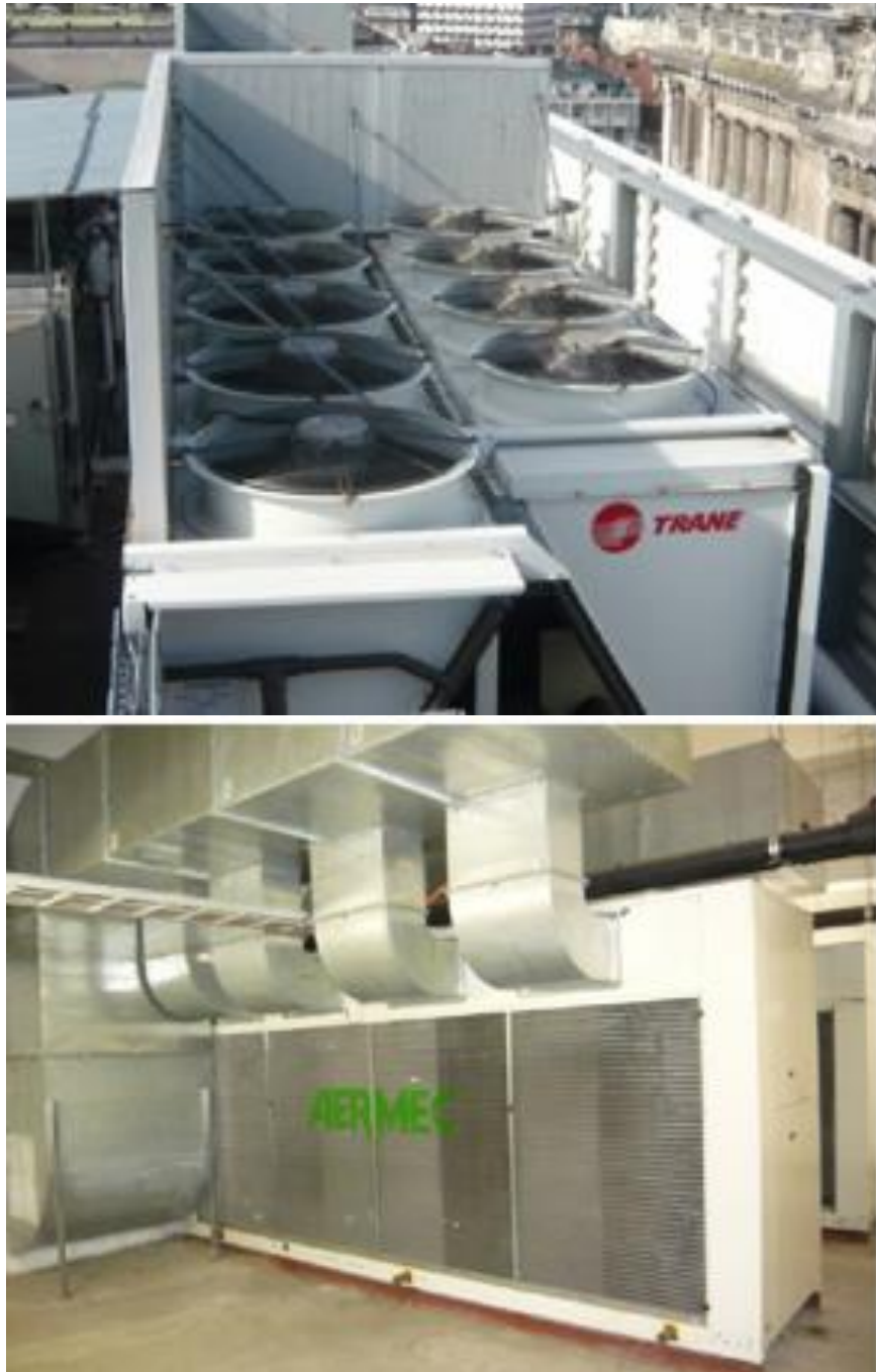
Figure 7: Groupe de production de froid, au-dessus TRANE et en dessous AEMEC.
