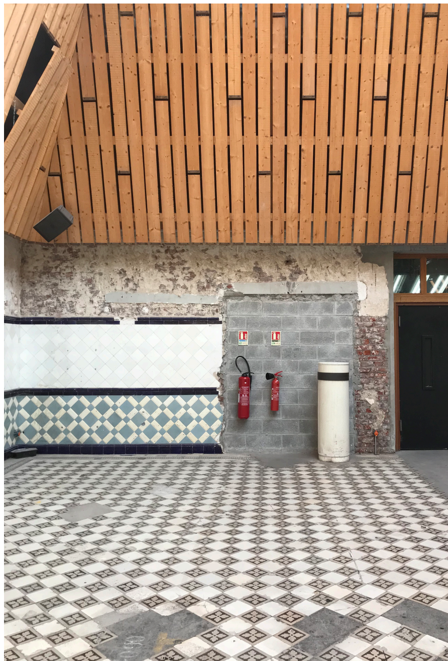
Fig. 26 Le minimum d'interventions dans La Verrière : des interventions contemporaines marquées (parpaings, boiseries) face aux matériaux anciens (carrelages, briques), 2021
