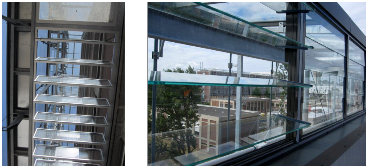
Figure 16 : Ventelles en partie basse et haute, construction21.org
