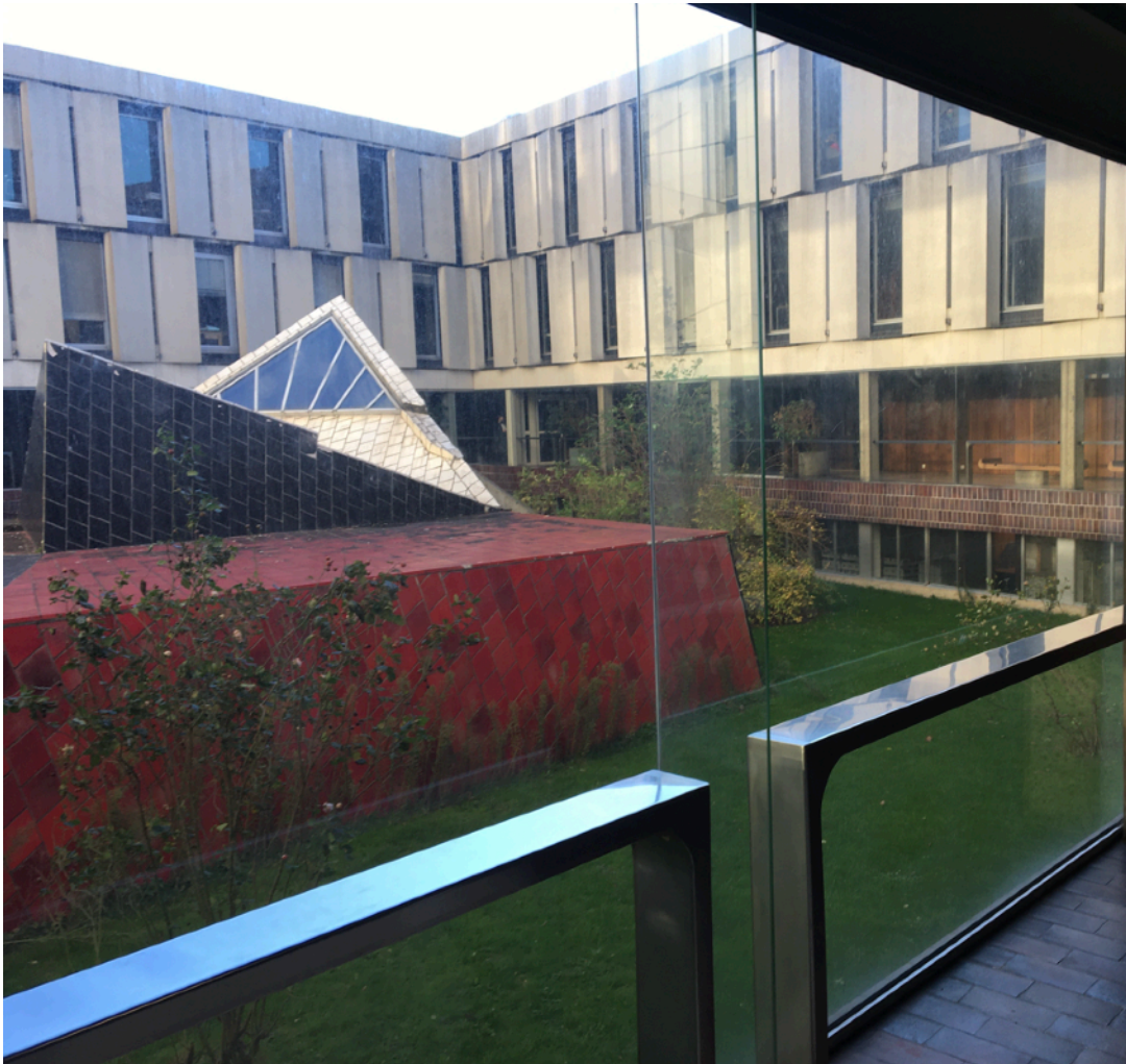
Figure 53 : Perte de la porosité à travers la façade au R+1 et R+2, vue depuis le rez-de-chaussée bas, Zachary ADJOU.
