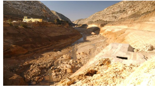
FIGURE 8: Barrage de Derna (45m) après la rupture.[16]
