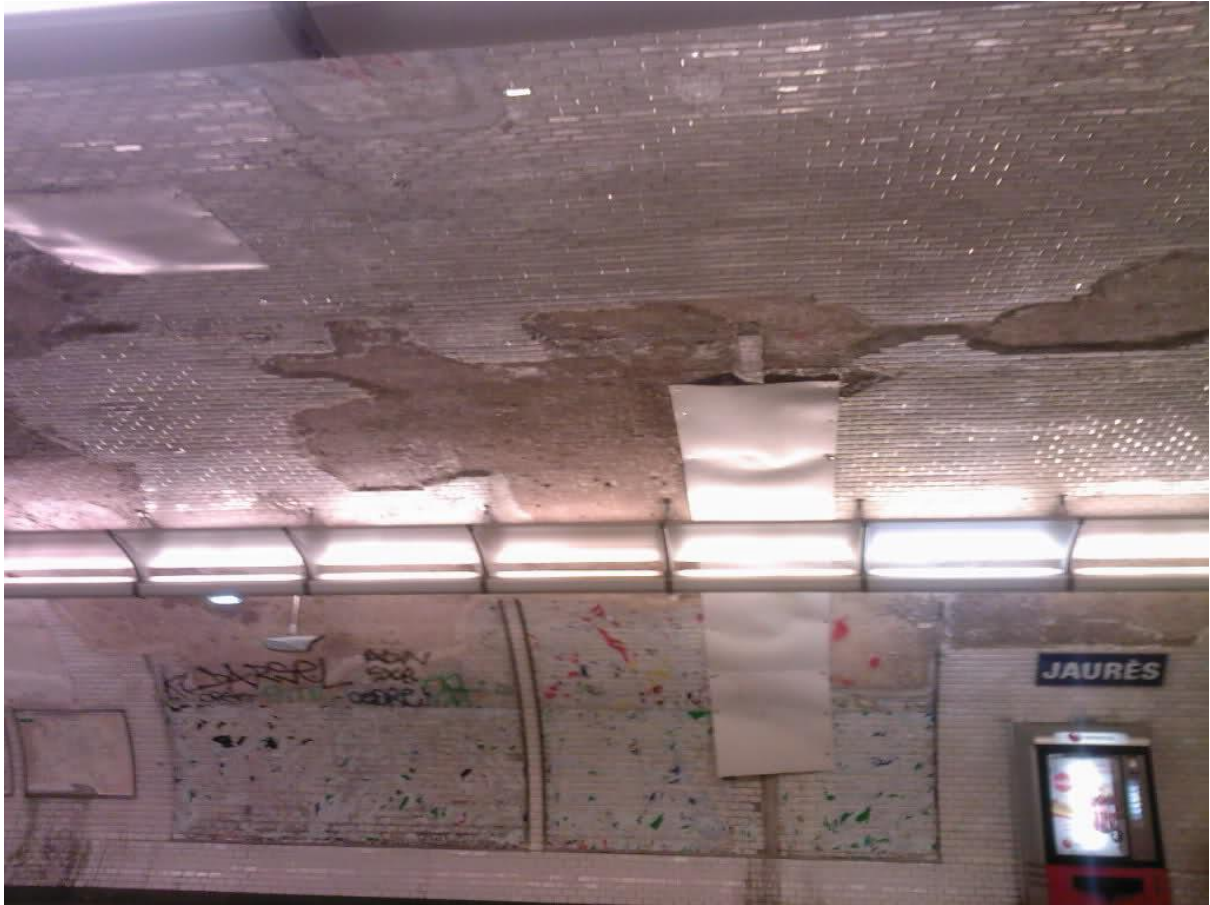
Fig. 31. Paris, station Jaurès, vue intérieure de la station, détails du mauvais état de la voûte (humidité, infiltration...), 2010.
