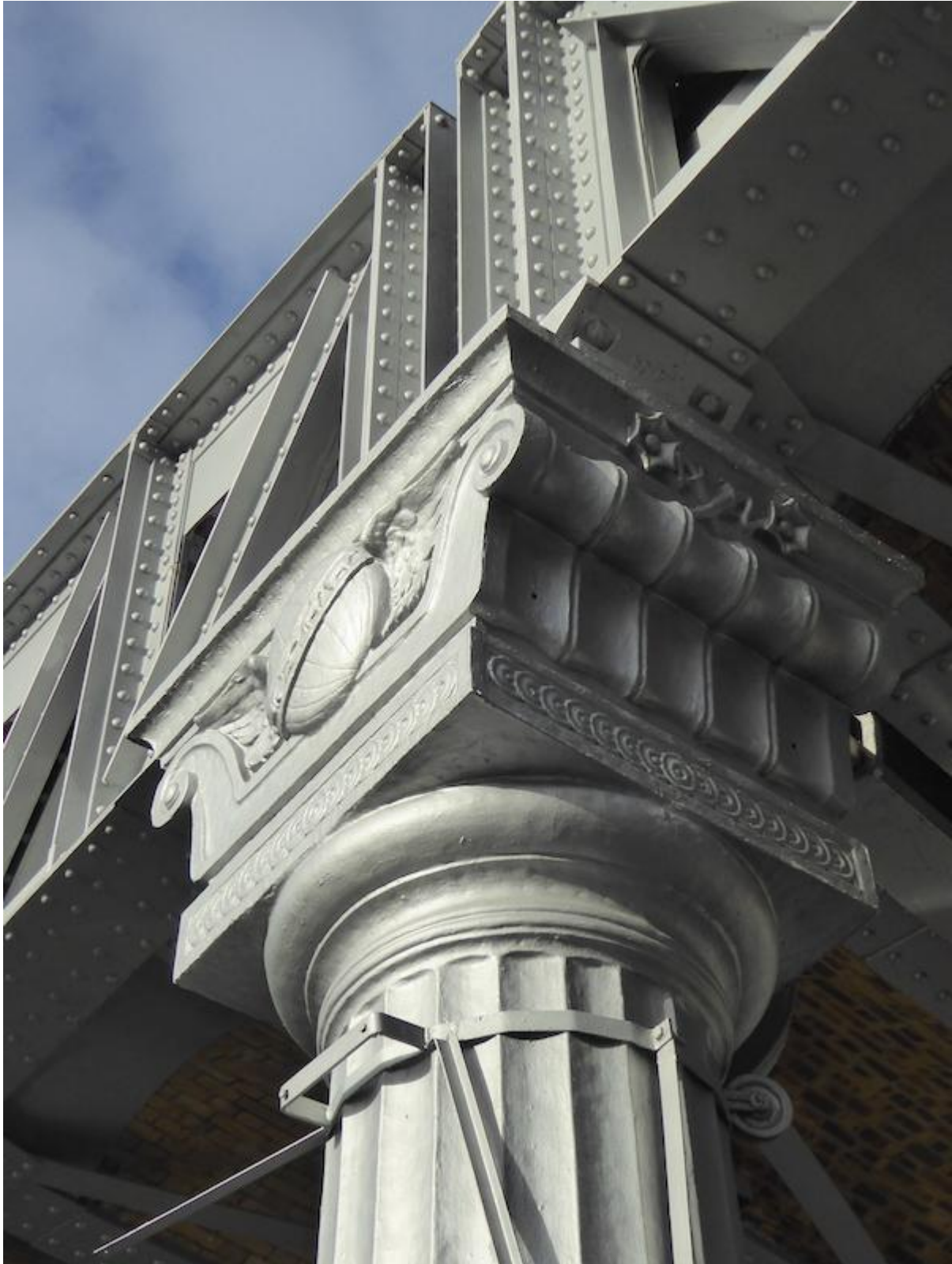
Fig. 37. Paris, station Gare d'Austerlitz, cliché de Dominique Perchet, détails des colonnes soutenant le tronçon aérien, 2016.
