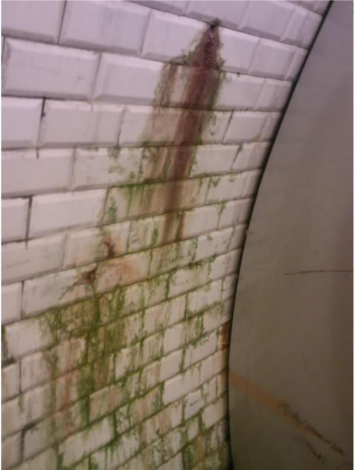
Fig. 32. Paris, station Jaurès, vue intérieure de la station, zoom sur les parois présentant des problèmes de moisissures et d'humidité, 2010.
