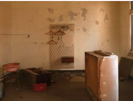
Fig 47- État des bureaux après l’explosion
