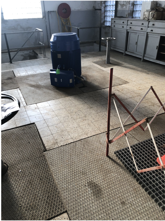
FIGURE 3.8 – Pompe qui remonte l'eau.
