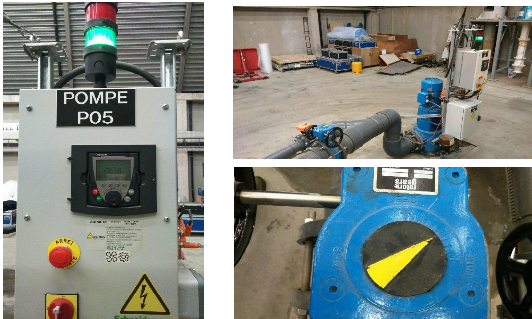
Figure 3.22: Pompe, raccordement de la pompe aux bassins de la passe à poissons et ouverture de la vanne du canal d'attrait
