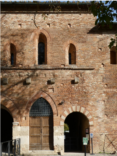
fig 49 : Couture verticale dans la maçonnerie
