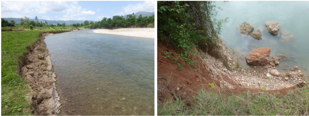
Figure 1.13: Érosion visible des berges aux alentours du PK 7 (gauche) et du PK 10 (à droite)
