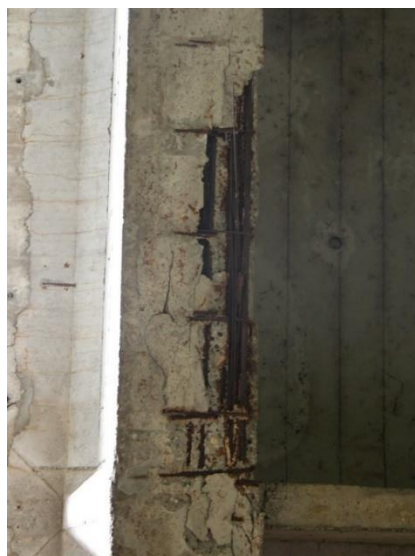
Figure 6: : Corrosion des câbles de précontrainte (pont de Pieve Porto Morone) [5]
