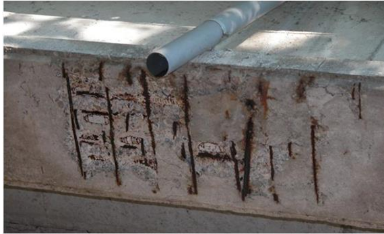
Figure 7: corrosion des câbles de précontrainte (Pont de San Daniele) [6]
