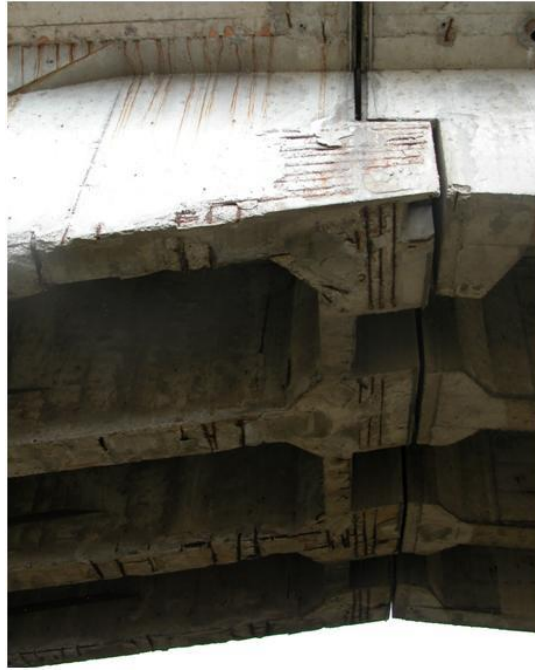
Figure 5: dégradation de la selle de Gerber (Pont de Pieve Porto Morone) [6]
