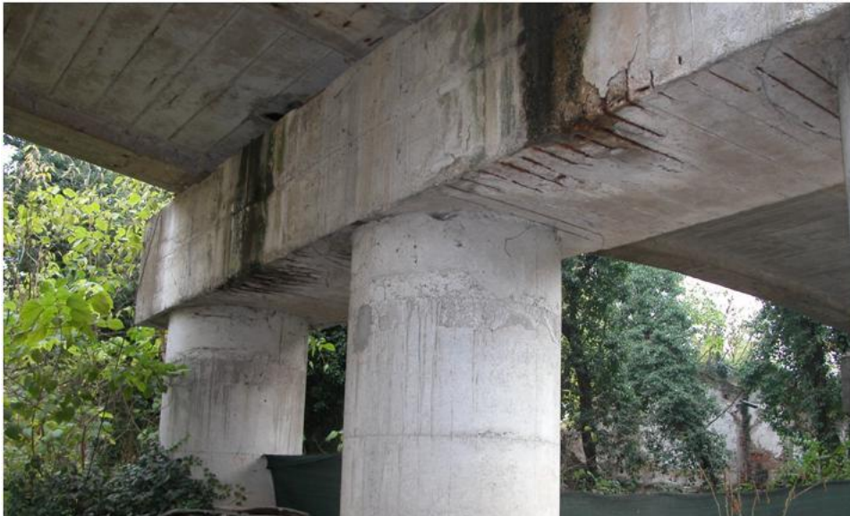
Figure 9: Absence de tuyaux d'évacuation (Pont de Ficarolo) [6]
