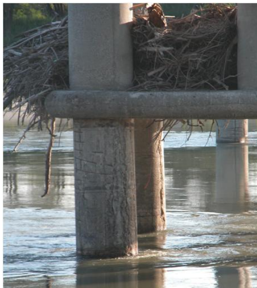
Figure 8: Pilier subissant de la corrosion (Pont de San Daniele) [6]
