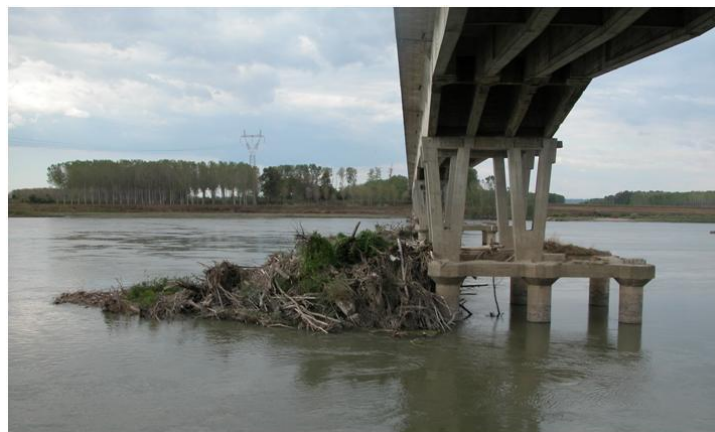
Figure 3: "Île de débris" formé contre un pylône du pont de Pieve Porto Morone
