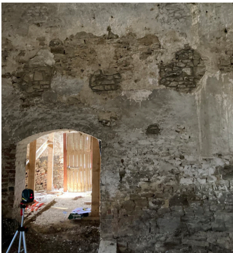
Fig. 151 Traces visibles d'anciens ancrages dans le mur de refend. CdA (13.03.2022).
