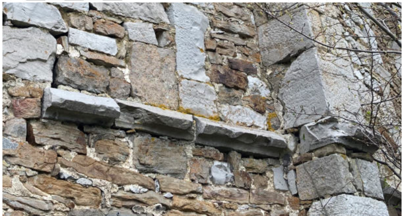
Fig. 116 Fissure d'un calcaire de Meuse. 2 e contrefort sud. CdA (20.11.2021).
