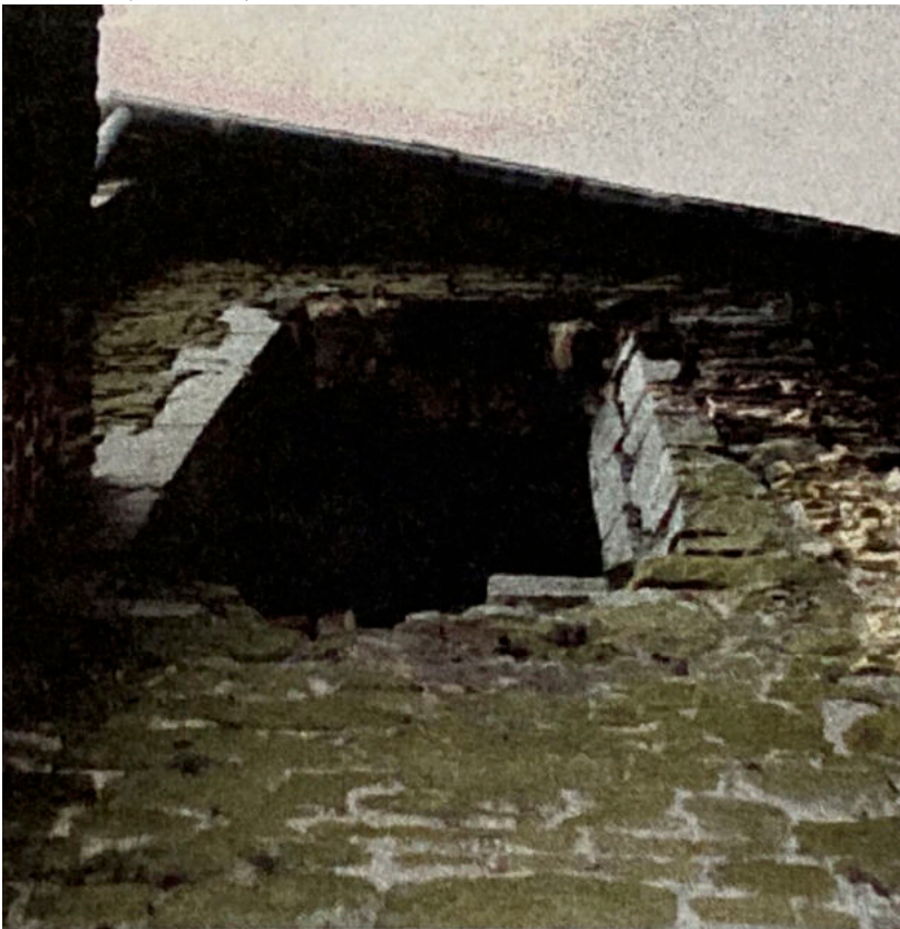
Fig. 119 Algues sur du calcaire de Meuse. Façade nord. CdA (21.02.2021).
