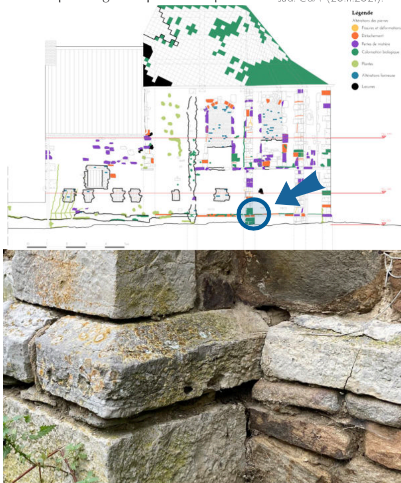
Fig. 114 Délitage du calcaire de Meuse. Soubassement sud. CdA (20.11.2021).
