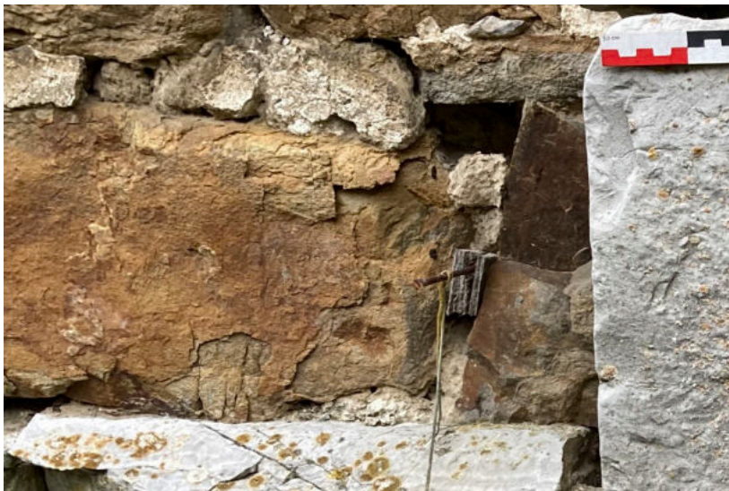
Fig. 121 Exfoliation de grès houiller. A gauche du 1 er contrefort sud. CdA (03.04.2021).
