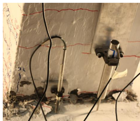
Figure 184 - Fissures verticales de compression sur la face latérale gauche de la colonne C1B au LS32
