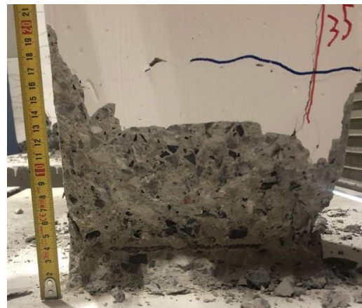
Figure 87 - Ecrasement du béton colonne C2C
