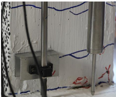
Figure 196 - Fissures verticales de compression sur la face latérale droite de la colonne C3C au LS31
