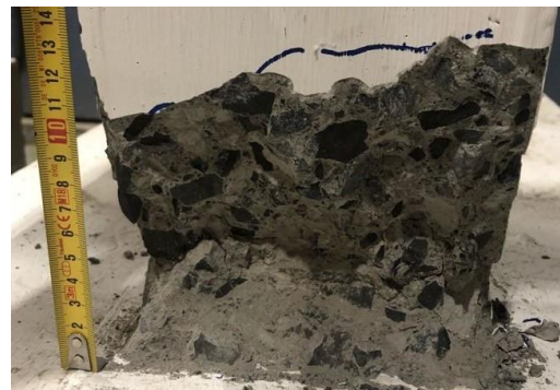
Figure 96 - Ecrasement du béton colonne C3B
