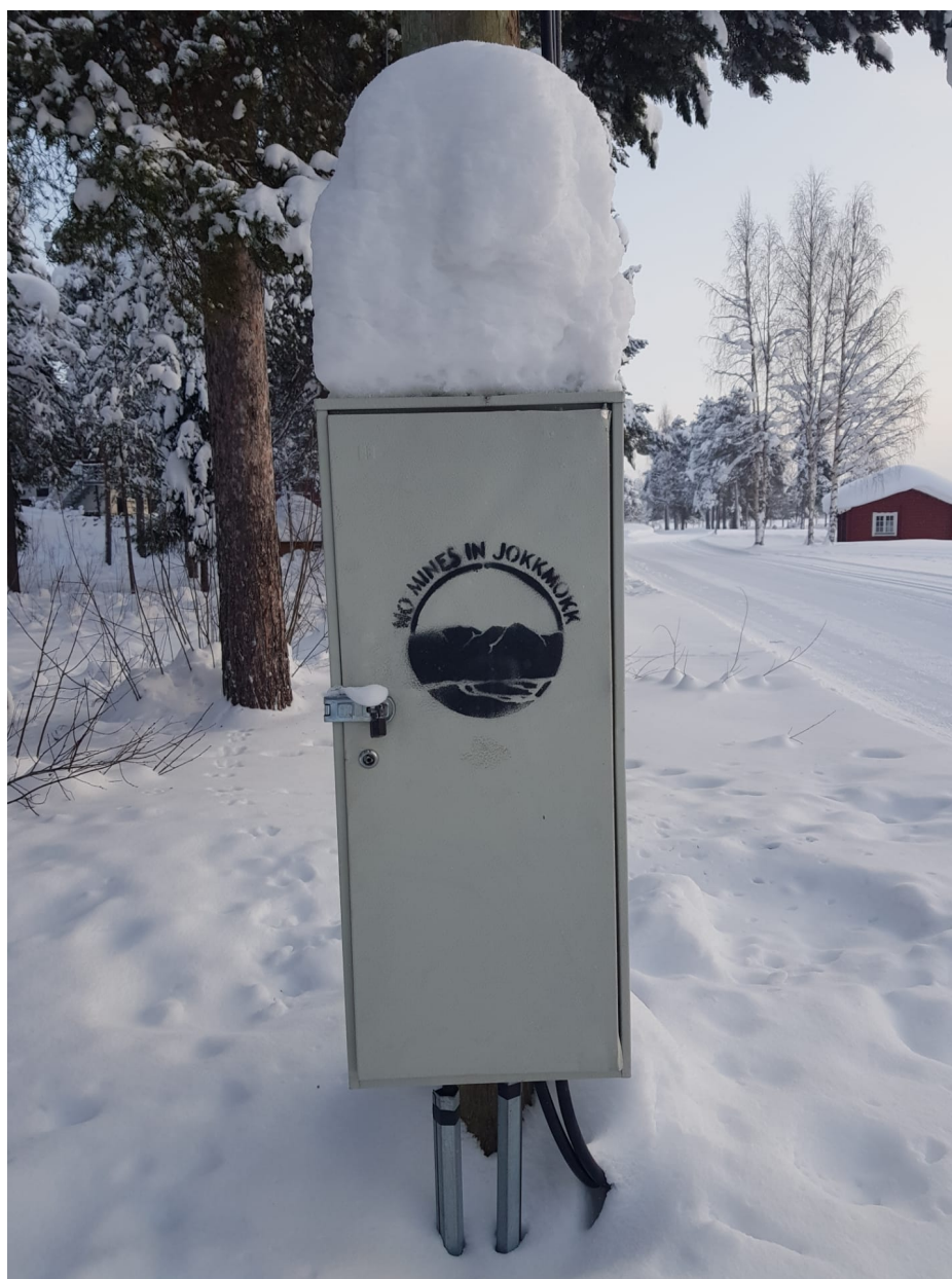
Figure 7 : Graffiti sur un panneau électrique de Jokkmokk. Photo : L. Beyaert, 20 décembre 2020.
