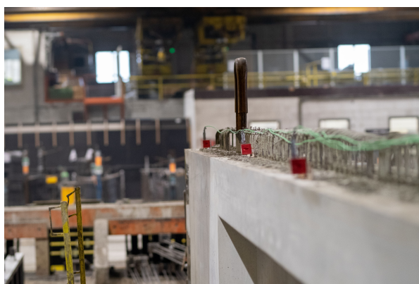
FIGURE 6.8 – Inclinomètres fixés sur la semelle supérieure de la demi-poutre
