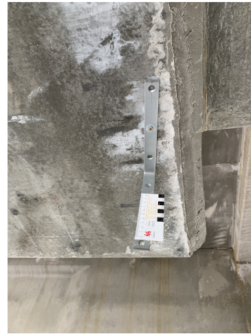
FIGURE 7.13 – Exemple de règle graduée en place sur la poutre
