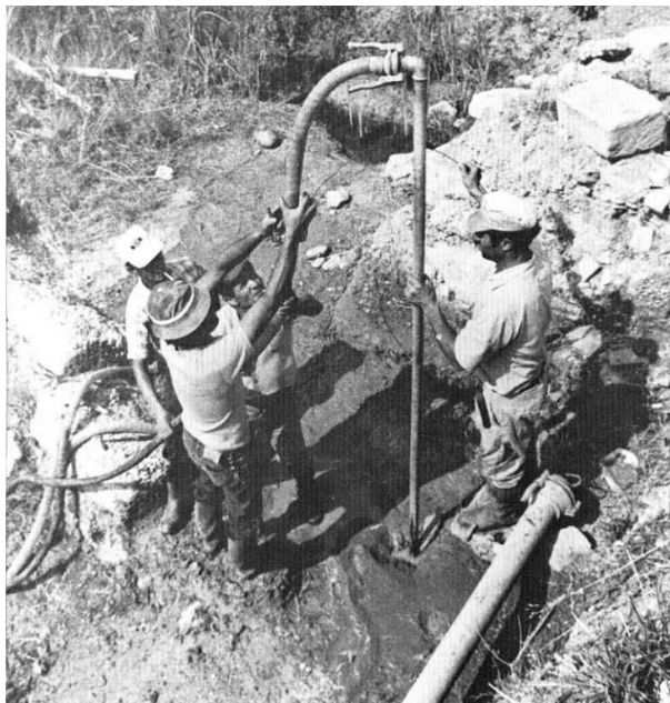
Fig. 10. Installation du système de pompage en 1982 (CARTER, 1983, p. 20).
