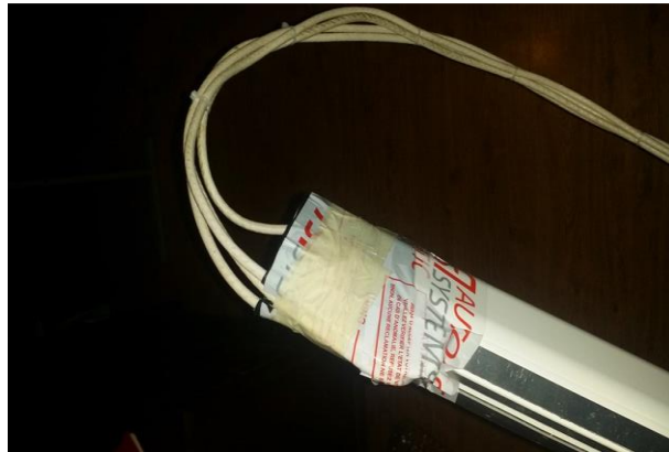
Figure 60 : lisse avec le câble coaxial
