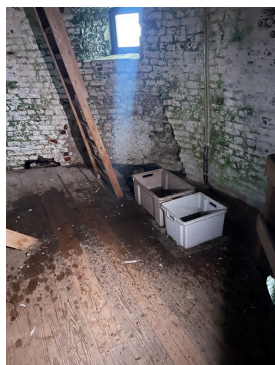
Infiltration d'eau à travers la toiture
