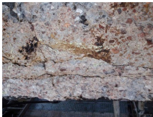
FIGURE 7 – Morceau de béton soumis à un incendie [4]
