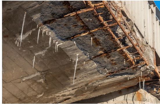
FIGURE 6 – Écaillage du béton suite à un cycle de gel-dégel [20]
