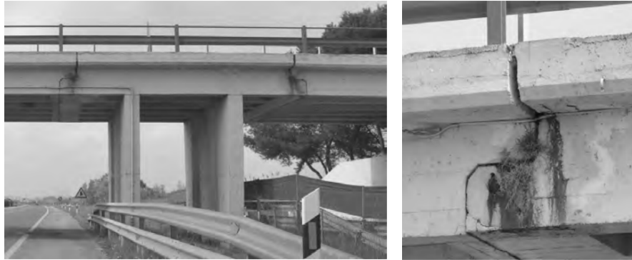
FIGURE 73 – Exemple d'une détérioration d'une DEB dans un pont routier [46]
