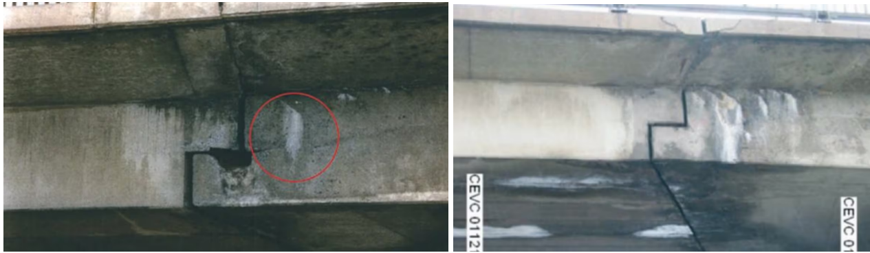
FIGURE 75 – Photographie du détail pendant les inspections en 1992 (gauche) et en en 2004 (droite) [98]
