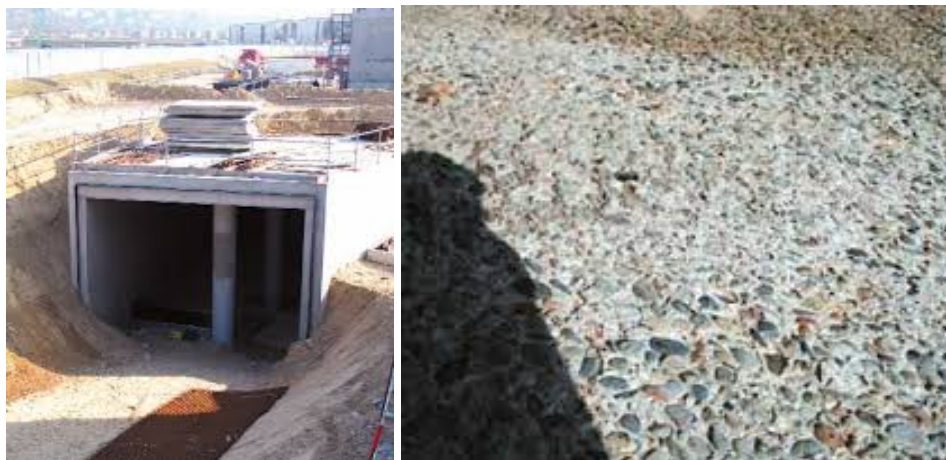
FIGURE 8 – Ouvrage hydraulique altéré par la lixiviation - Aspect du béton altéré par la lixiviation [7]
