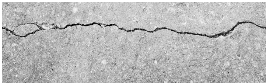
FIGURE 5 – Fissure provoquée par le retrait du béton [28]
