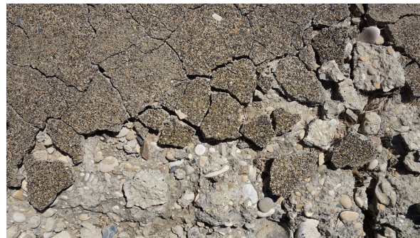
FIGURE 16 – Érosion du béton [24]
