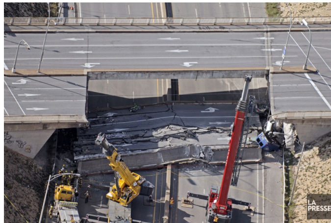
FIGURE 76 – Photographie de l'effondrement du viaduc de la Concorde [98] (Canada)
