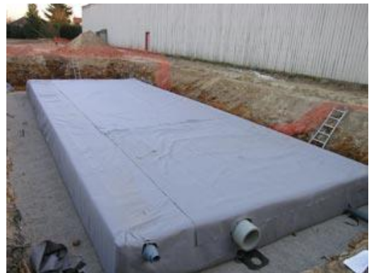
Figure 2 : Bassin de rétention enterré
