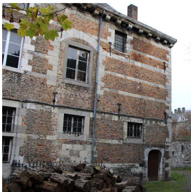
FIGURE 160 Articulation sud-est du couvent, l'élévation méridionale présente une étrange baie ainsi qu'une couture entre différentes maçonneries, probablement la trace d'un phasage de construction. Photographie : M.Vanel, décembre 2020.
