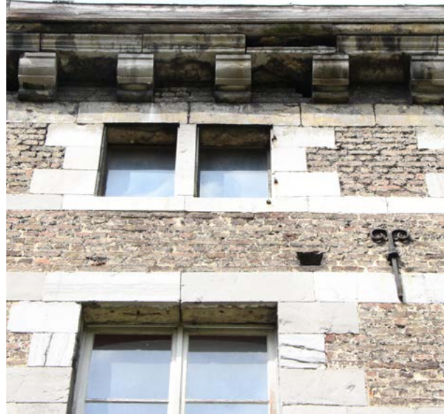
FIGURE 120 Baie de surcroît à 2 jours (US.73), corbeaux et corniche en calcaire (US.26 et 27), ancre étirée en Y (US.75) et trous de boulin (US.76) au niveau du couvrant de l'étage de l'aile méridionale. Photographie : M.Vanel, juin 2022.
