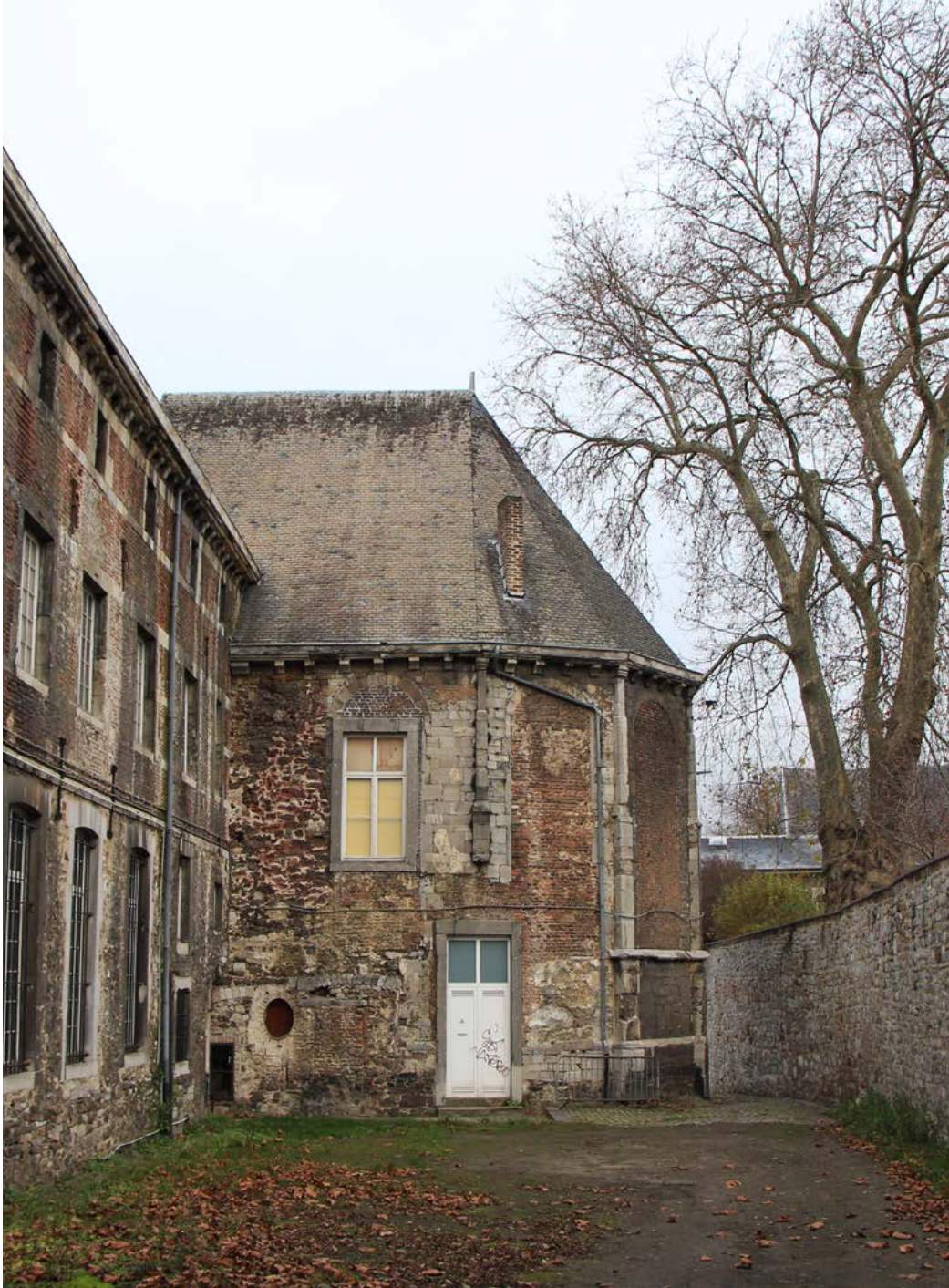
FIGURE 3 L'état de l'élévation sud du chevet de l'ancienne église témoigne de l'urgence d'un projet de restauration. Photographie : M. Vanel, décembre 2020.
