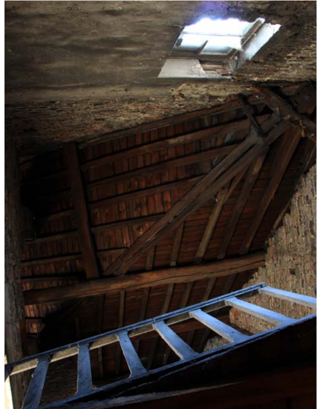
FIGURE 112 Charpente couvrant la cage d'escalier. On distingue la structure de la noue ainsi qu'une panne mal équarrie. Photographie : M.Vanel, février 2021.
