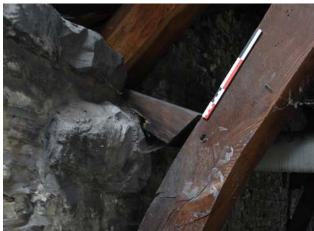
FIGURE 130 Le blochet en conflit avec la saillie du corbeau, côté intérieur. Photographie : M. Vanel, mai 2024.
