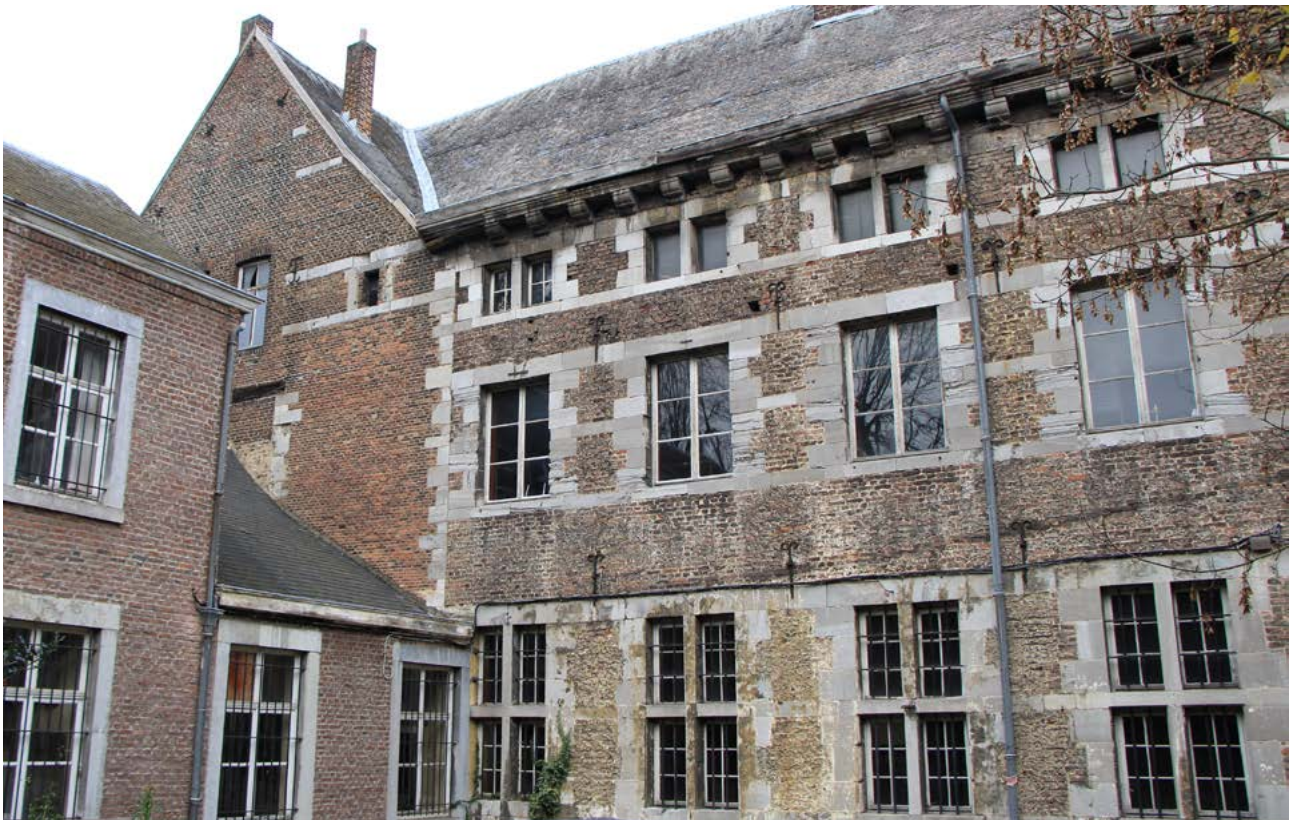
FIGURE 121 Les bandeaux de façade en pierre calcaire viennent buter contre la chaîne d'angle du pignon attenant, sans alignement recherché. Photographie : M.Vanel, décembre 2020.
