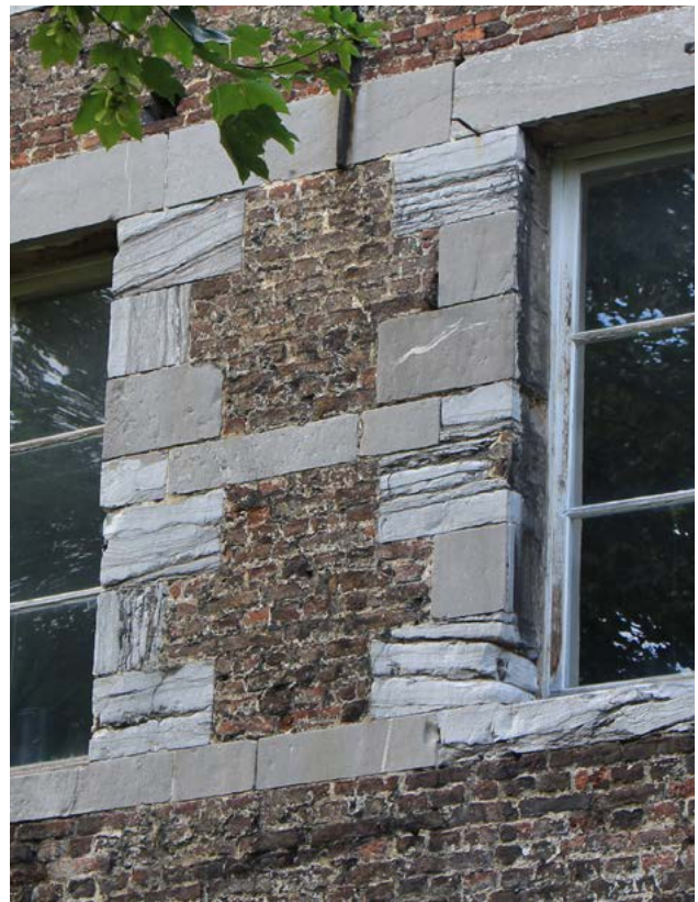
FIGURE 119 Pierres calcaires présentant des terrasses fort marquées (US.27) au niveau des encadrements de baie de l'étage. Photographie : M.Vanel, décembre 2020.
