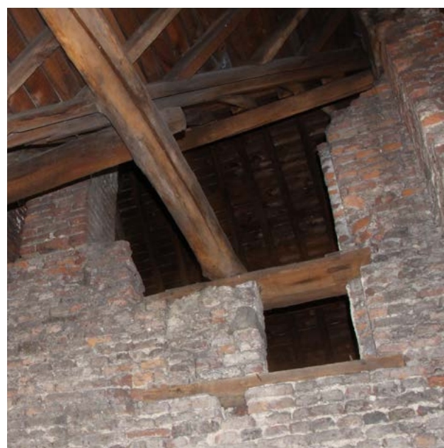
FIGURE 107 Sur le mur M.03/04.F.04, ancienne huisserie de porte (US.08). Photographie : M.Vanel, juin 2022.
