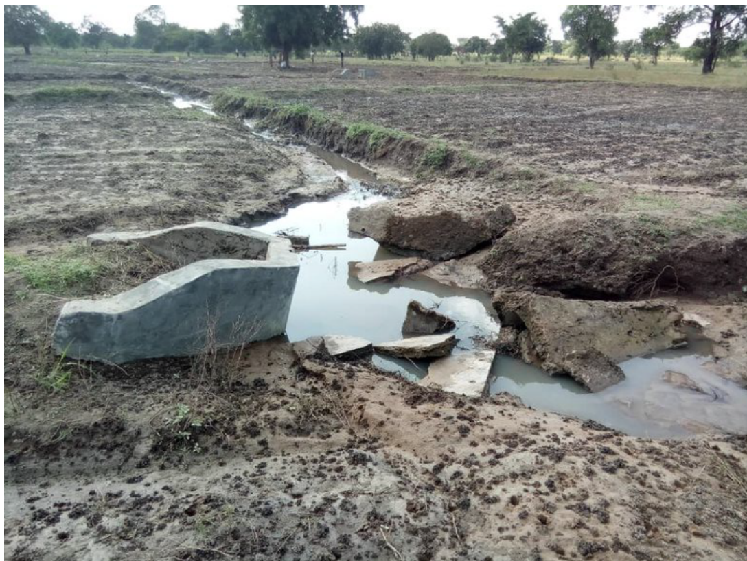
FIGURE E.1 – Aménagement sommaire dans le bas-fond (déversoir en béton après endommagement par une forte pluie)
