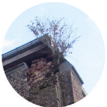
2. Végétation invasive et détachement partie supérieure du contrefort
