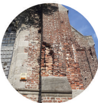
6. Briques qui se détachent
