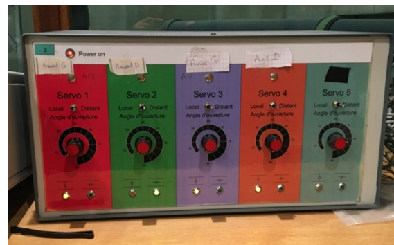
Figure 4-22 : Boîtier de contrôle des servo-vannes
