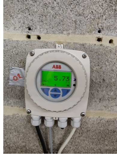
(b) Valeur lue sur un débitmètre
