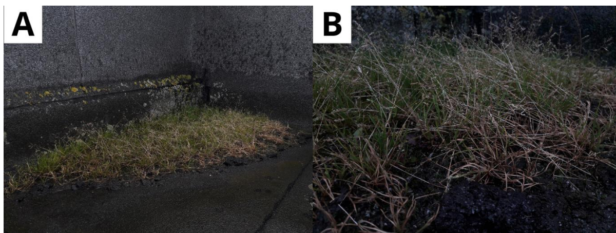
Figure 44 : A. Herbes ayant poussé sur le toit du Cinéscope – B. Zoom sur l'herbe, juste en-dessous on observe la « mauvaise » boue et les paillettes d'ardoise.
