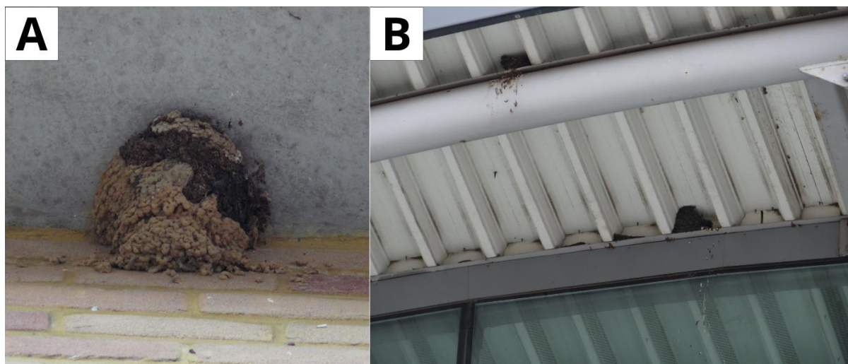
Figure 40 : A. Réparations de 2024, partie plus foncée sur la photo, reposant sur une base de "bonne" boue – B. Nids sur la façade de l'Esplanade reposant sur l'arcade métallique du toit (photo Z. Jilali).
