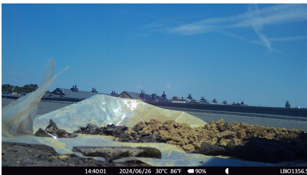
Figure 39 : Test de la bâche sur le Cinéscope, on observe à gauche qu'elle est soulevée par le vent, des bouts de verres trouvés sur le toit ont été ajoutés pour retenir la bâche, sans succès, 26 juin 14h40.
