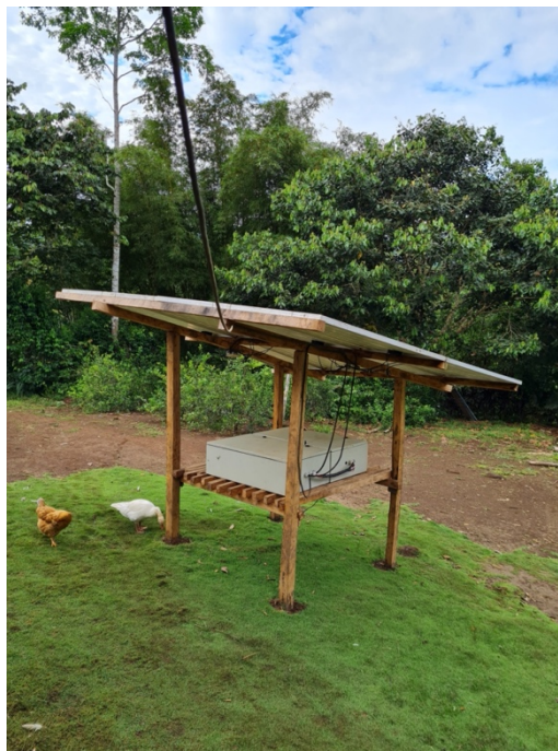
Figure 17. Dispositif Internet fonctionnant avec l'énergie solaire. Obepare, juillet 2021.
