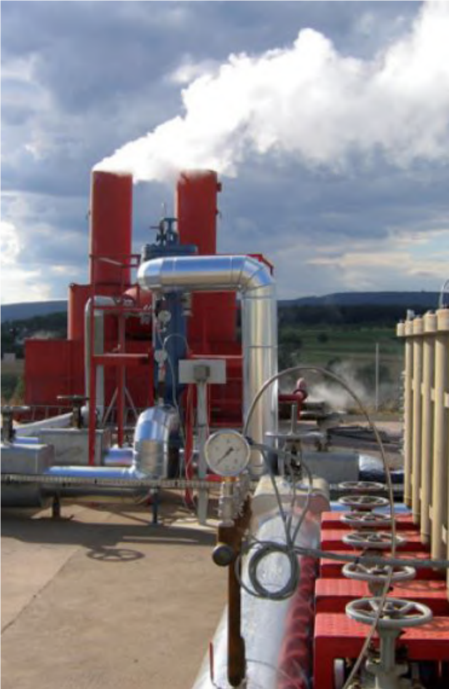
Photo 28 Centrale électrique géothermique de Soultz-sous-Forêts (France)
