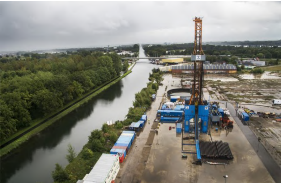
Photo 32 Plateforme de forage de station géothermique de Mol (Province d'Anvers) Vue d'ensemble
