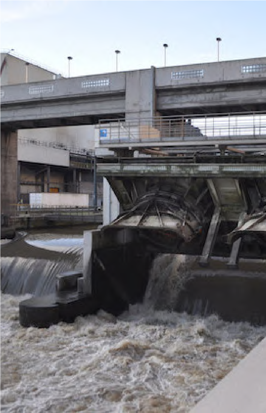
Photo 17 Centrale hydroélectrique de Charleroi : Marcinelle II
