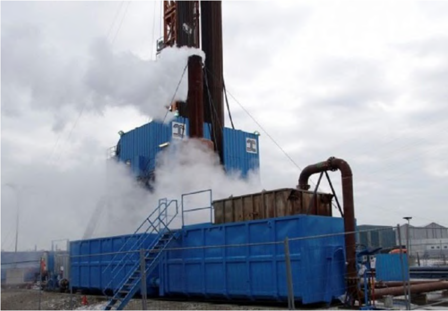
Photo 31 Plateforme de forage de station géothermique de Mol (Province d'Anvers) Zoom sur le puits de forage
