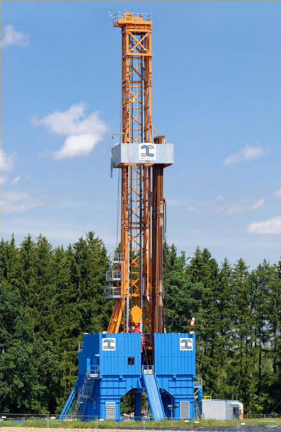
Photo 30 Plateforme de forage de station géothermique de Mol (Province d'Anvers) Puits de forage de +/- 4000 mètres
