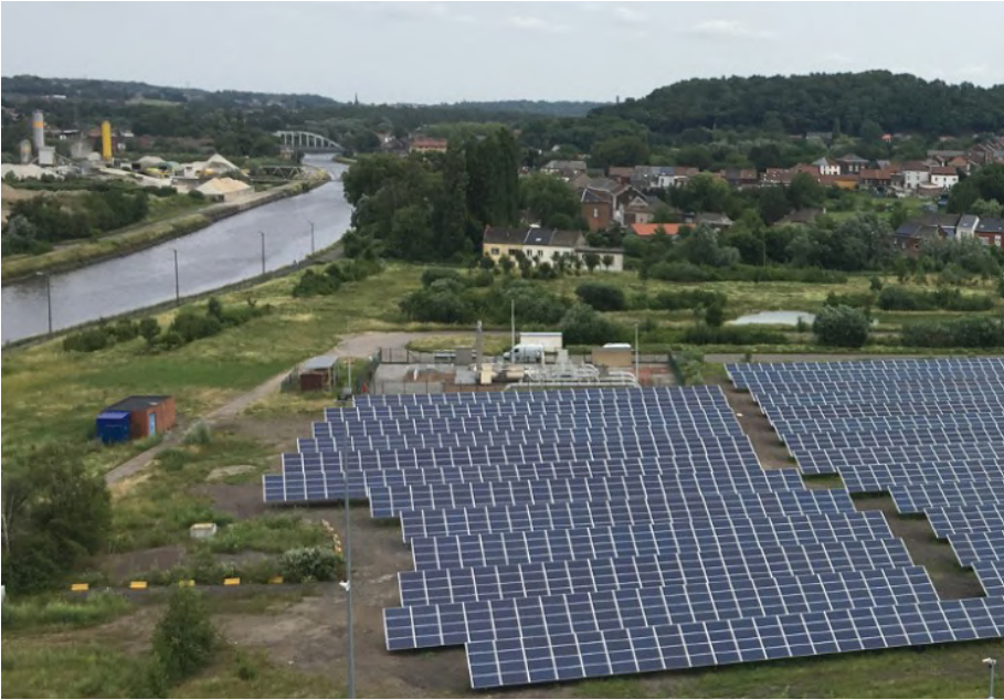
Photo 19 Les 3680 panneaux photovoltaïques de la centrale d'Amercoeur à Charleroi
