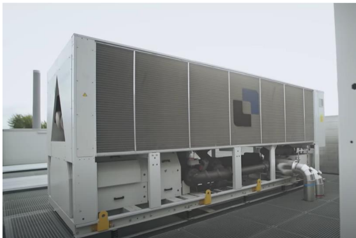
Photo 7 : système de refroidissement (Comarch France, 2018)
