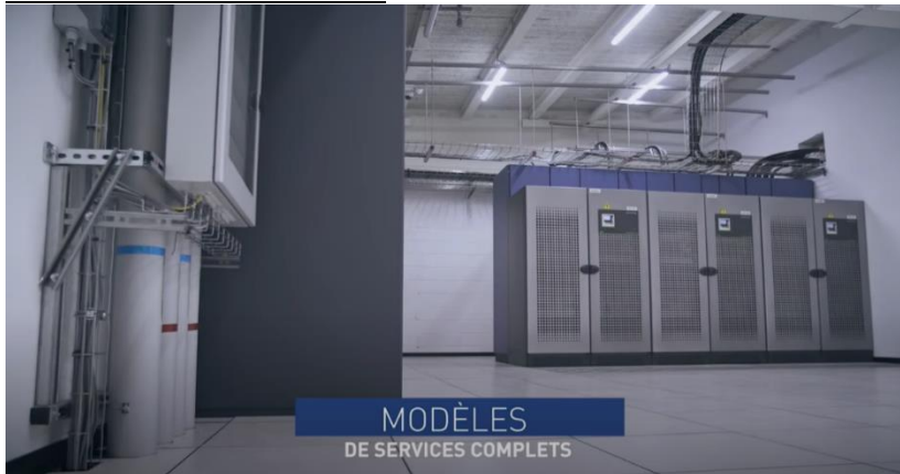
Photo 3 : Salle des onduleurs (Comarch France, 2018)
