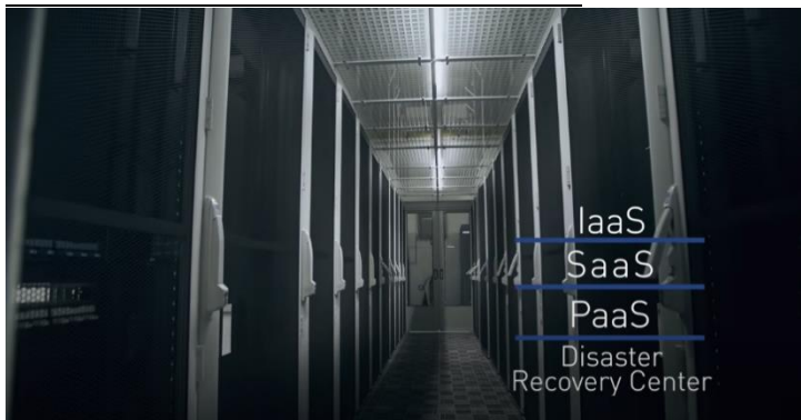
Photo 5 : intérieur du bloc des serveurs (Comarch France, 2018)
