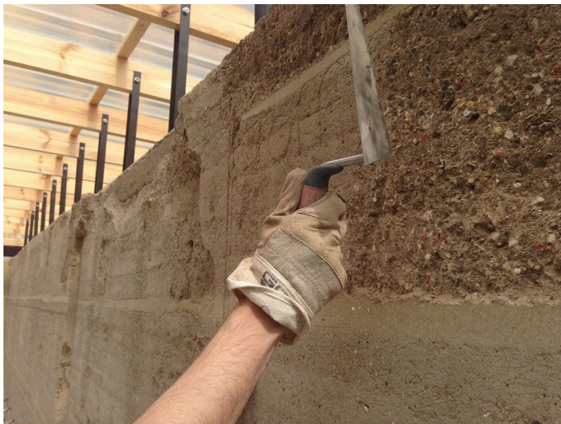
Figure 53 : Erosion du mur en pisé de la Smoke House à cause des intempéries
