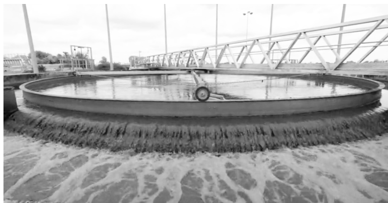
Débordement des bassins de la station d'épuration du Grimonpont
