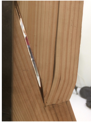
FIGURE 10.3 – Rupture par dépassement de la résistance de la surface d'about
